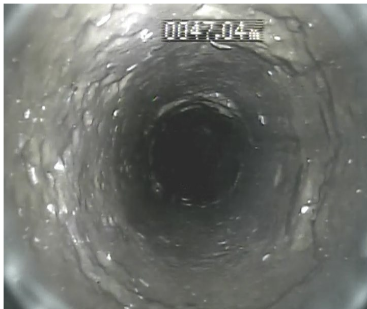
FOTO 06 - 47,04 metros, fratura com pequena infiltração.
